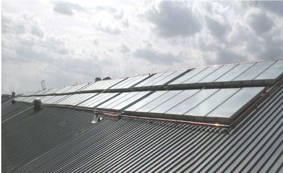
Instalación solar térmica en industria
