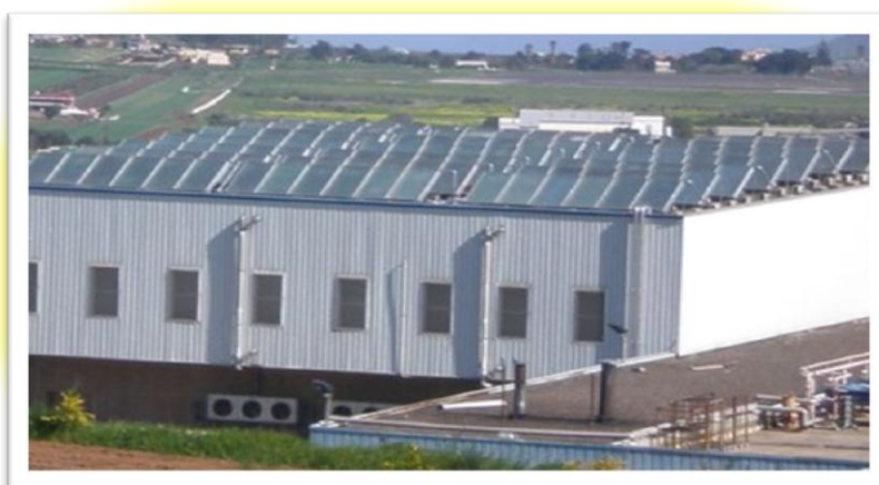
Slika 2: Ploščati sprejemniki na strehi proizvodne dvorane podjetja Montesano na Tenerifih, v La Esperanzi v Španiji
