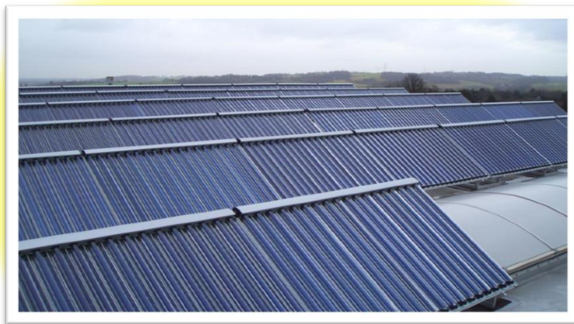
Slika 3: Vakuumski sončni sprejemniki (400 m 2 ) na strehi podjetja Steinbach & Vollmann v kraju Heiligenhaus v Nemčiji.
