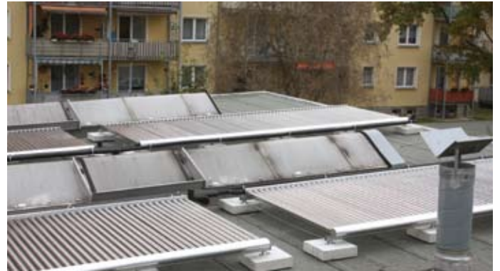
Abb. 19: Vakuumröhrenkollektoren auf dem Flachdach der Lackiererei. Die Absorberbleche in den Röhren sind dabei in der Halterung nach Süden verdreht.
