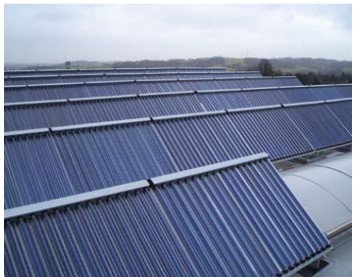
Abb. 22: 400 Quadratmeter Vakuumröhrenkollektoren sind auf dem Firmendach nach Süden ausgerichtet.
