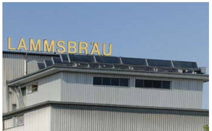
Abb. 23: Luftkollektoren auf dem Dach mit den Belüftungsrohren auf der rechten Seite.
